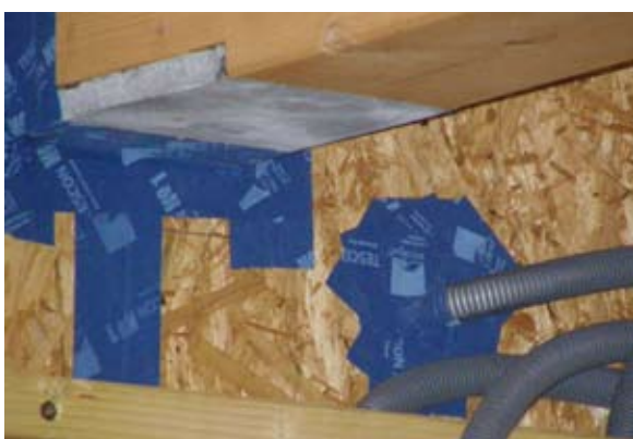
Pénétration de l'enveloppe par des gaines électriques
